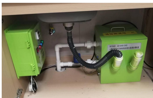
医疗废水处理设施照片
